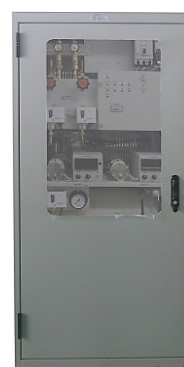
50LA2 (ガス分配架は 別設置)
